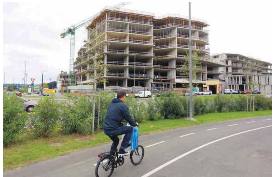
Grafist v okviru kompleksa Solis v Kopru – ki ima danes še podobo gradbišča – načrtuje tudi osemnadstropni hotel. FOTO ROMAN ŠIPIČ
